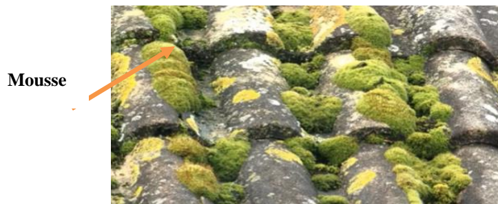
Figure 8 : Présence de mousse sur une toiture
