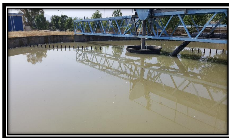
Figure 12 : Bassins d'assainissement des boues activées.
