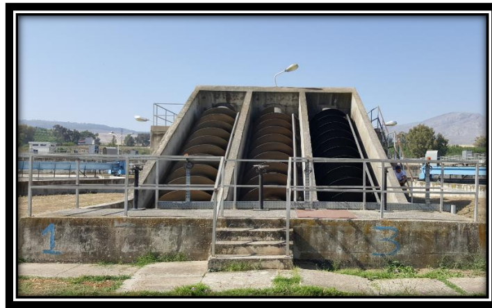
Figure 11 : Vue des pompes à vis.
