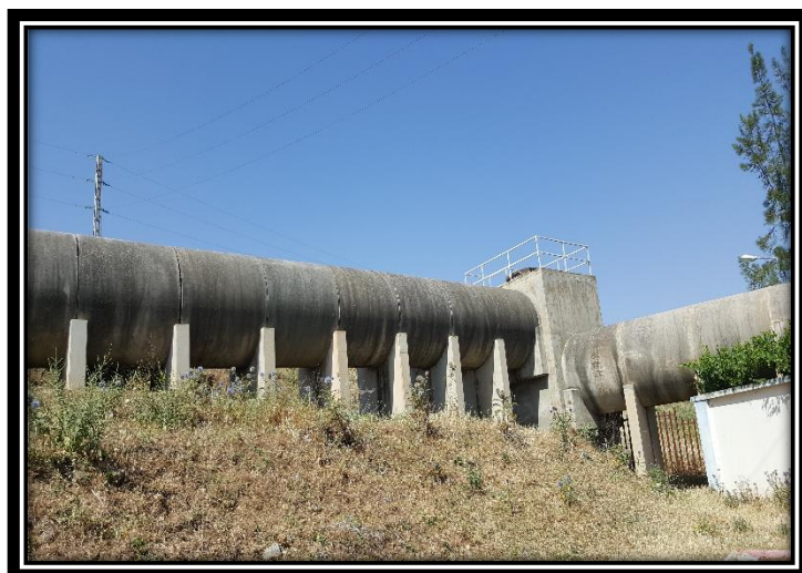
Figure 06 : Conduite principale des eaux usées qui alimentent la station d'épuration d'Ibn Ziad
