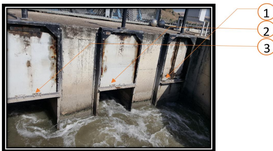
Figure 07 : Vue des trois entrées de l'eau usée au criblage grossier, avec des ouvertures manuelles (1, 2,3).
