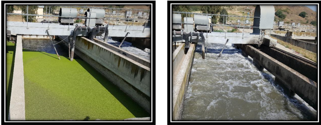
Figure 08: vue d'ensemble sur la séparation de la graisse (à gauche) et du sable (à droite).
