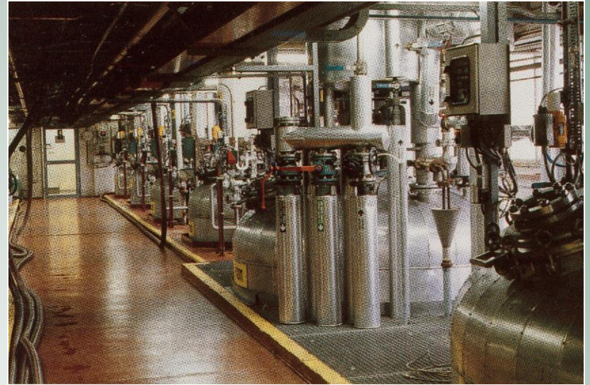
Vue générale sur la salle des fermenteurs
