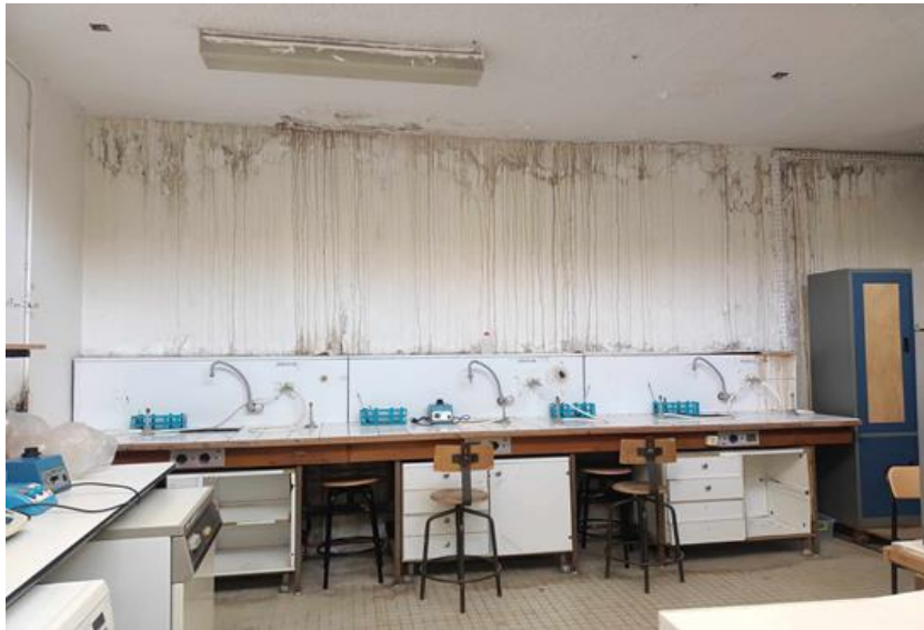
Figure 35 : Problème de taches noires sur le mur du laboratoire 11 (bloc des sciences).
