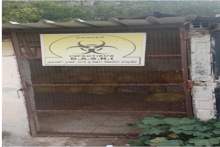
Figure16 : Niche de stockage final au niveau de L’EPH EL KHROUB. (Photo prise par nos soins le 24/03/2024.)
