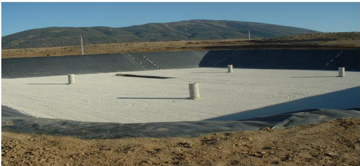
Casier d'enfouissement de déchets avec cheminée d'extraction du biogaz
