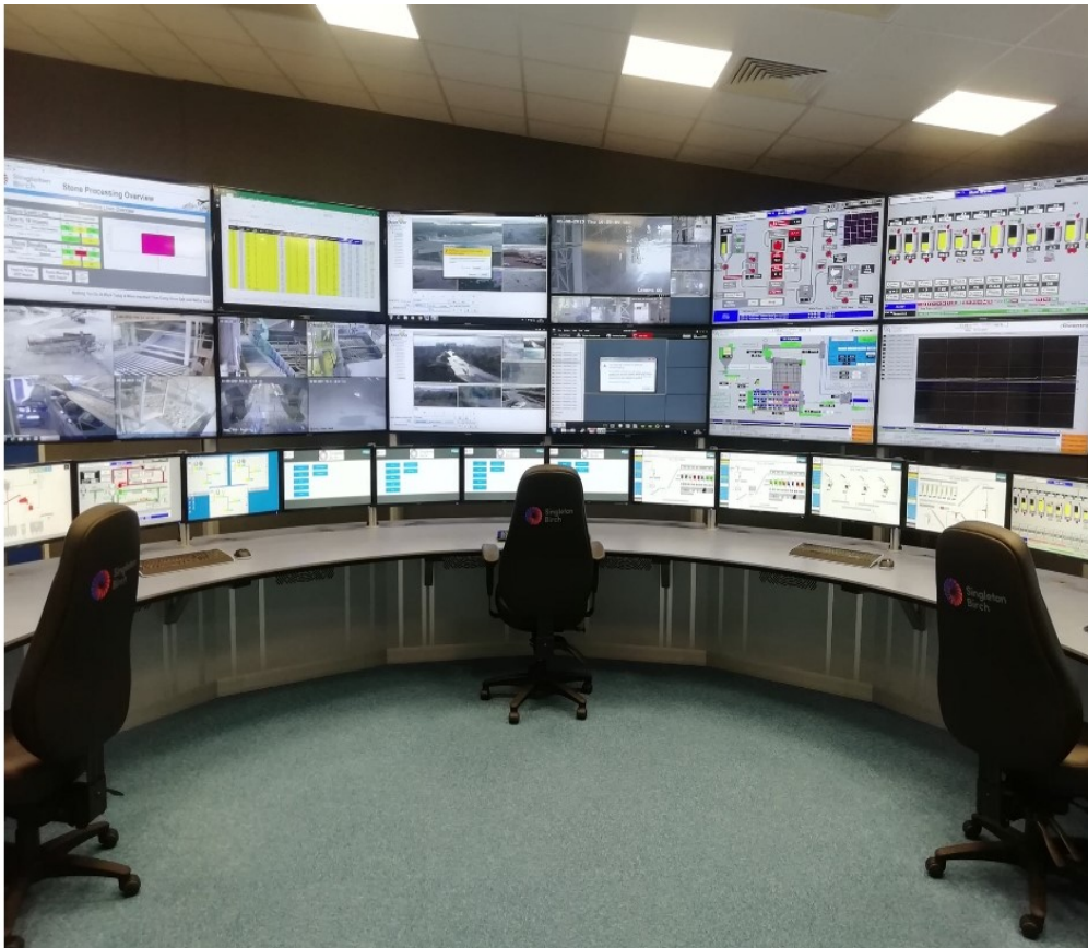
Figure 6 : système de contrôle en ligne des mesures de gaz
