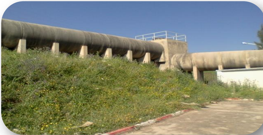
Photo II.1: Conduite principale des eaux usées qui alimentent la station d'épuration
