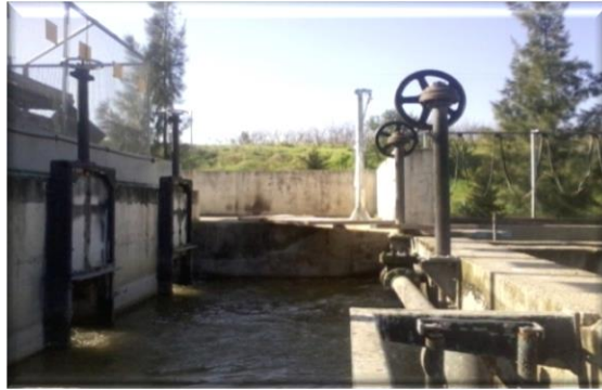
Photo II.2: Vue des deux entrées de l'eau usée au criblage grossier, avec des ouvertures manuelles qui en service.
