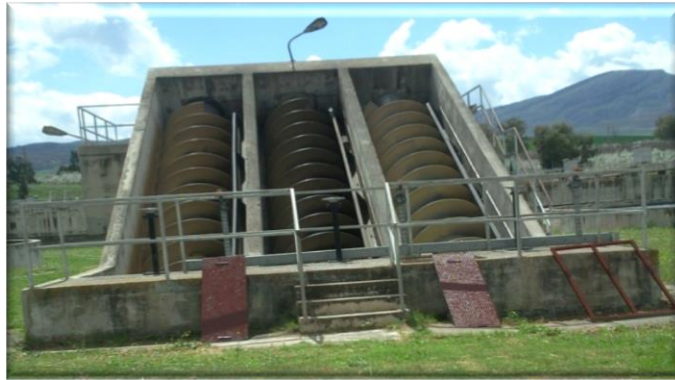
Photo II. 6 : Vue des trois pompes à vis
