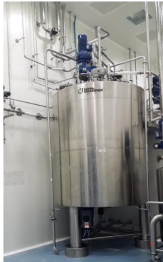
Figure 9 : la cuve de préparation .
