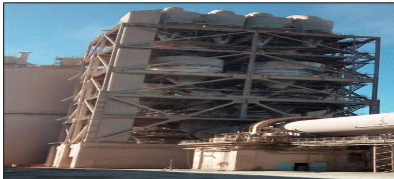
Figure 7 : Tour de préchauffage
