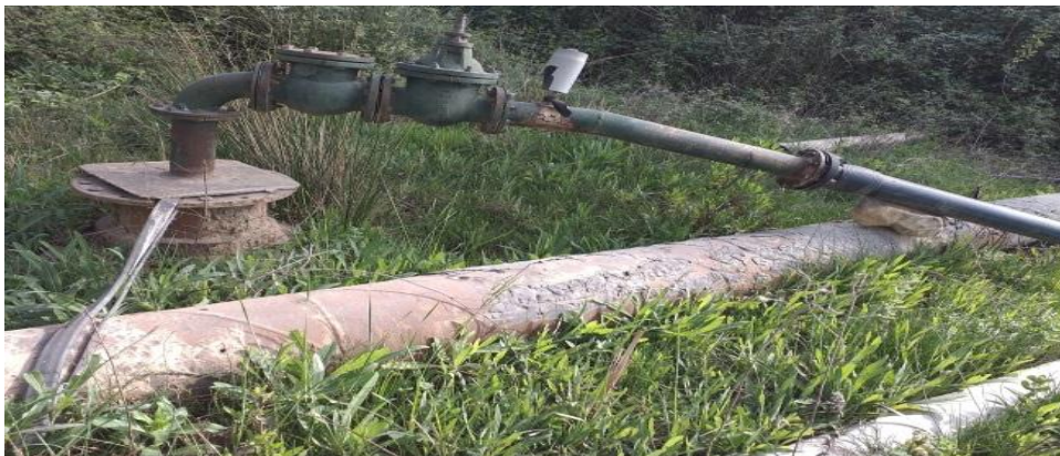
Figure 9 : Photo de station de pompage Base de vie.
