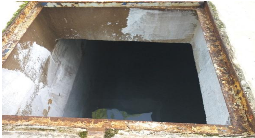
Figure 11: Photo de Réservoir Gare.
