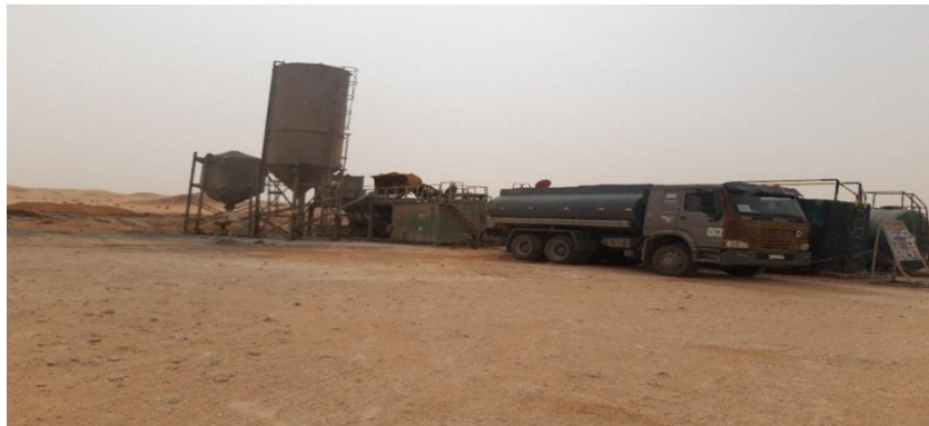
Figure 8 : Photo de l'unité de traitement stabilisation/solidification (Chouaoua & Idami, le 4/4/2019)
