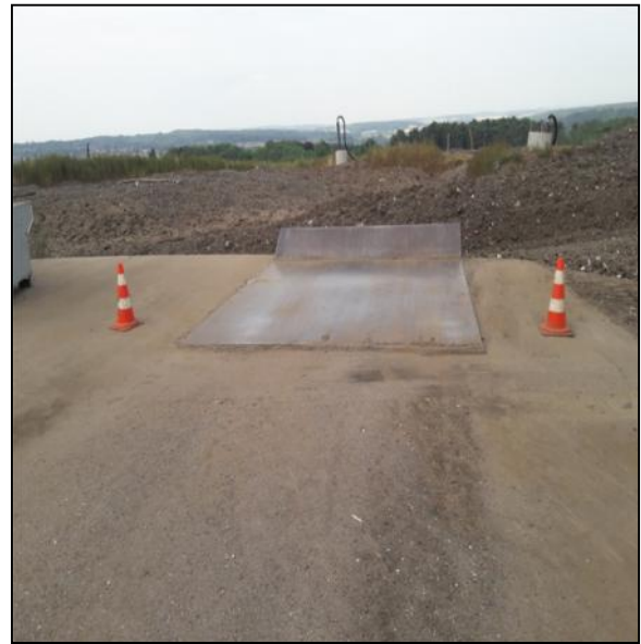
Quai de déversement
