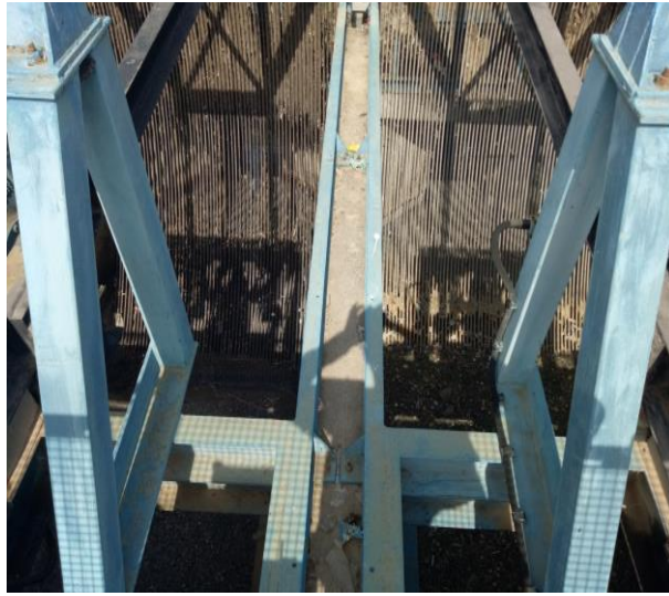
Photo 03 : Dégrilleurs mécaniques (STEP Ibn Ziad, Constantine, le 12/05/2019)
