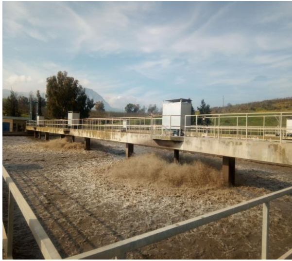
Photo 04 : Bassins d'aération (STEP Ibn Ziad, Constantine, le 12/05/2019)
