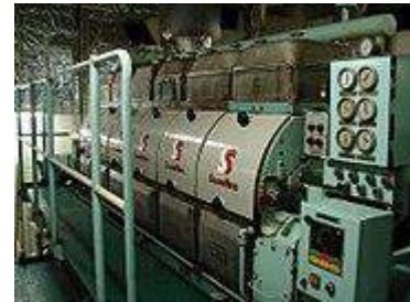
Diesel-alternateur sur un pétrolier
