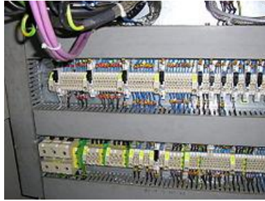
Connexions dans une armoire d'automate
