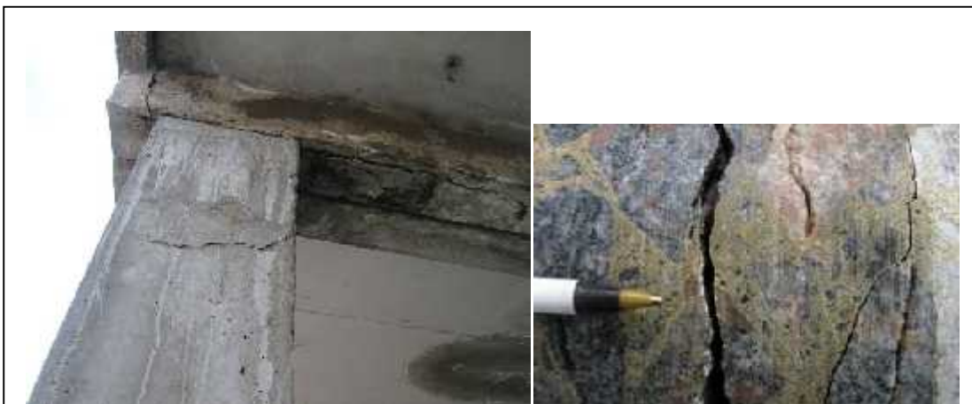
Figure 5.2 : Gonflements et fissurations importantes dans les bétons dus à l'ARG
