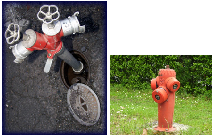
Bouches ou poteau d'incendie
